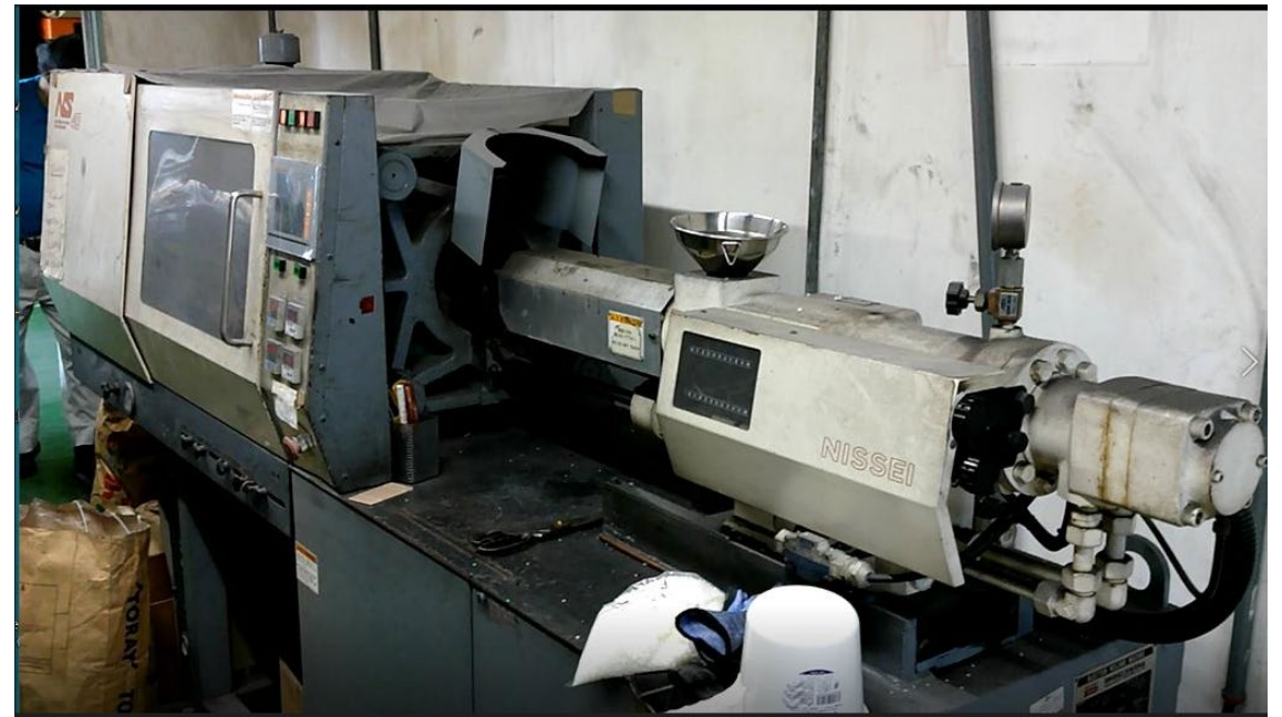
設備外観 (NISSEI製)
